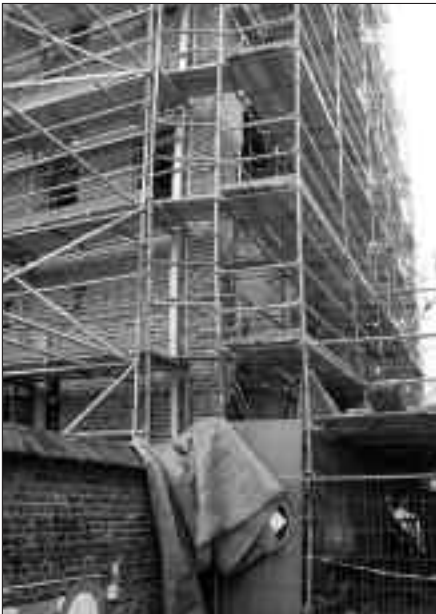
Ingestorte zijgevel: toestand 1966
